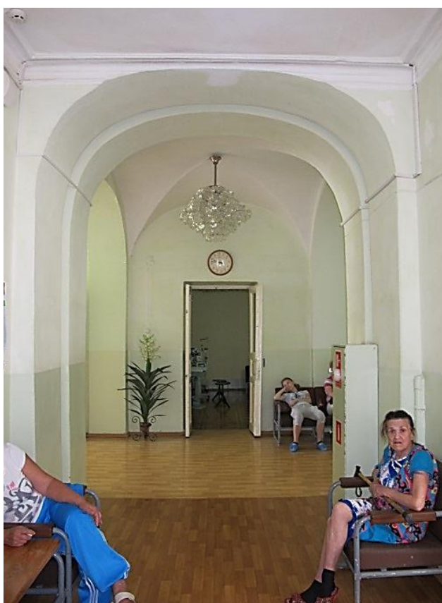
Видовая точка № 41. Коридор второго этажа, трехцентровые арки, плоское перекрытие с штукатурными тягами, кирпичный крестовый свод
