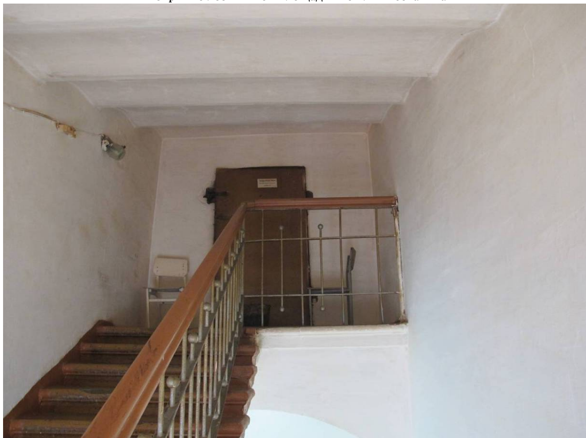
Видовая точка № 51. Помещение лестницы дворового крыла с выходом на чердак. Перекрытие из кирпичных сводов по металлическим балкам, кирпичный свод в конструкции лестничной площадки
