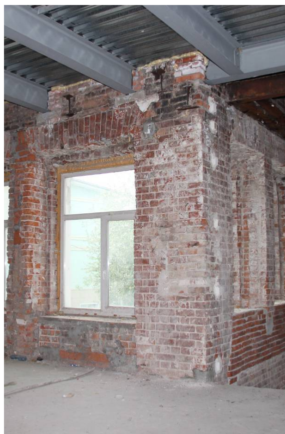
Видовая точка № 14. Вид окон с клинчатыми перемычками (Леонтьева Н.М., 02.07.2017 г.)
